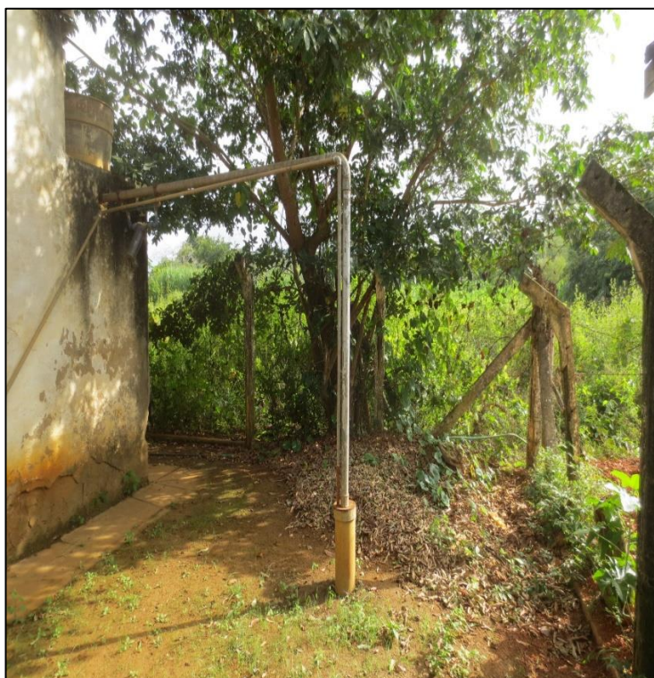
Figura 29 - Poço de captação no Distrito de Angaturama.
