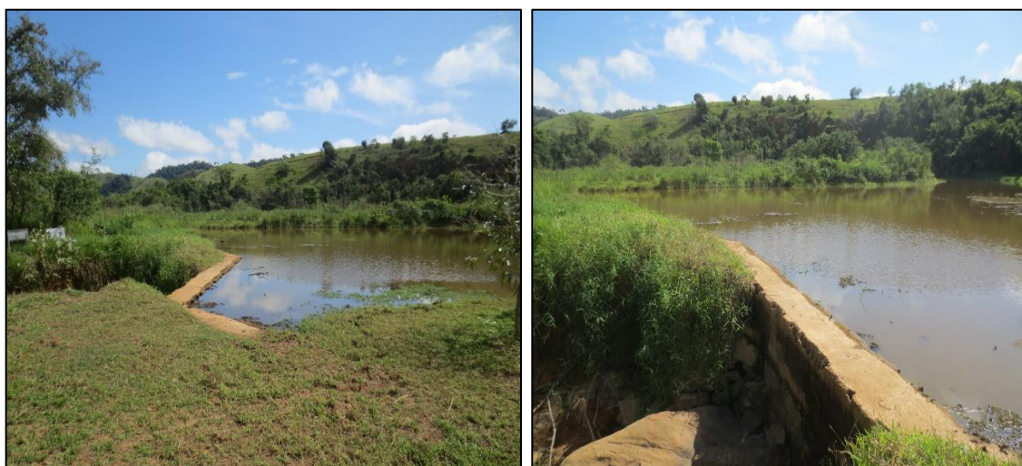
Figura 25 - Captação de água no ribeirão Dos Monos para o abastecimento urbano no Distrito Sede.
