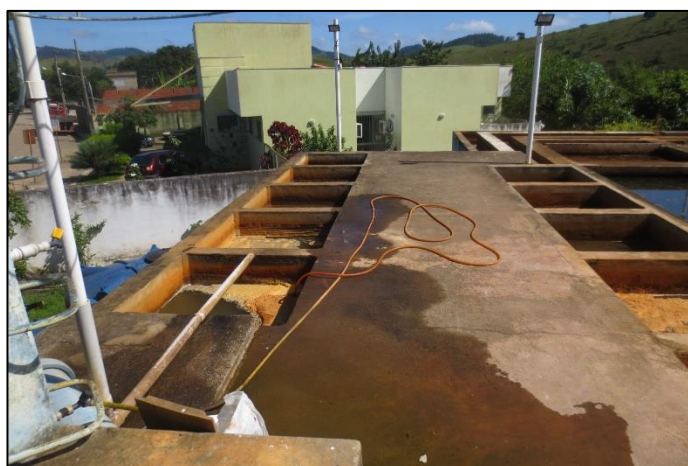
Figura 32 – Câmaras de floculação hidráulica.
