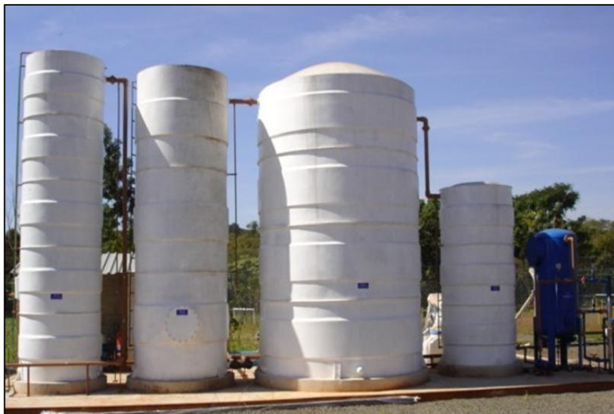
Figura 87 – Estação Compacta de Tratamento de Esgotos Sanitários.
