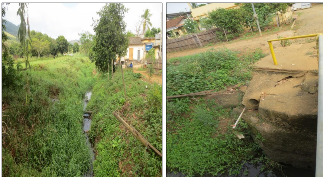
Figura 43 - Corpo hídrico receptor e lançamento de esgoto in natura no Distrito de Barreiros.
