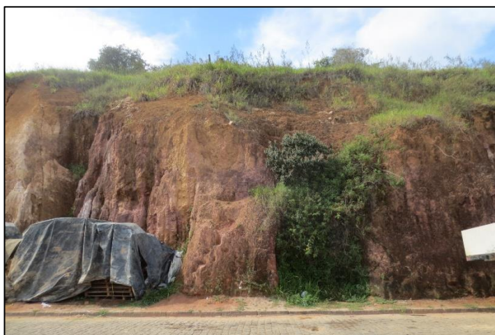
Figura 73 - Erosão na área urbana de Recreio.
