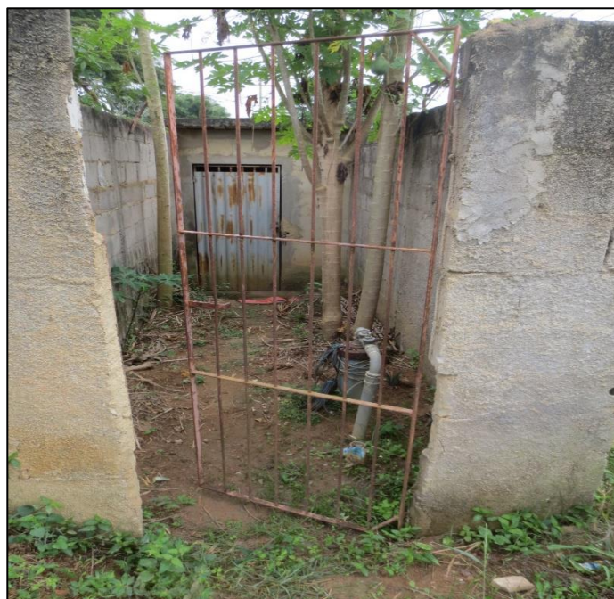
Figura 27 - Poço de captação no Distrito de Conceição da Boa Vista.
