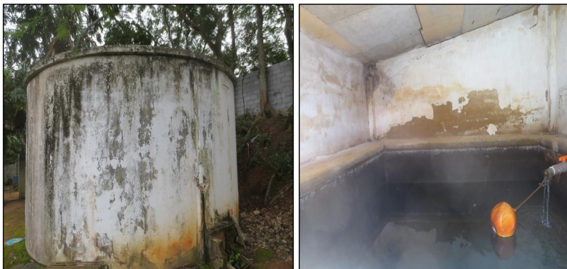
Figura 38 - Reservação nos Distritos de Conceição da Boa Vista e Angaturama.
