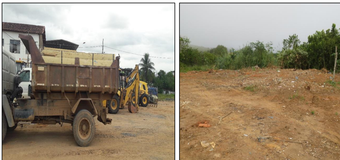
Figura 51 - Caminhão basculante para a recolha do RCC e bota fora irregular.
