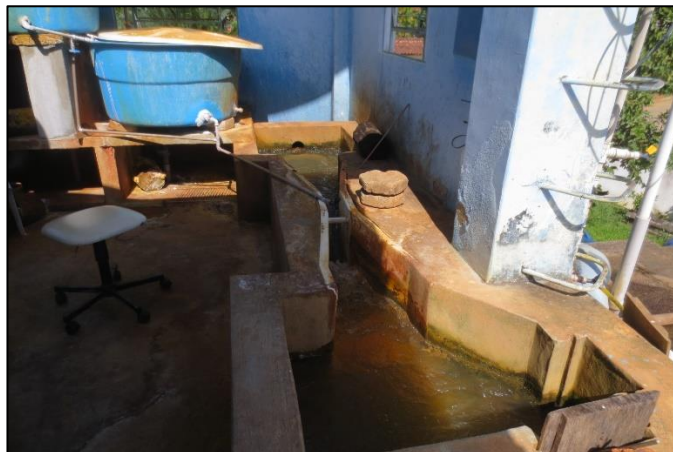
Figura 31 – Calha Parshall e adição de sulfato de alumínio.
